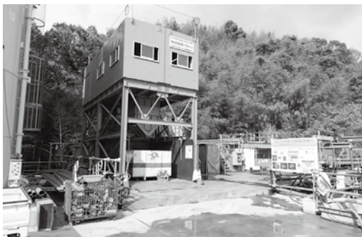
写真15 濁水処理プラント
