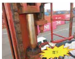
外れて落下する危険がありました
